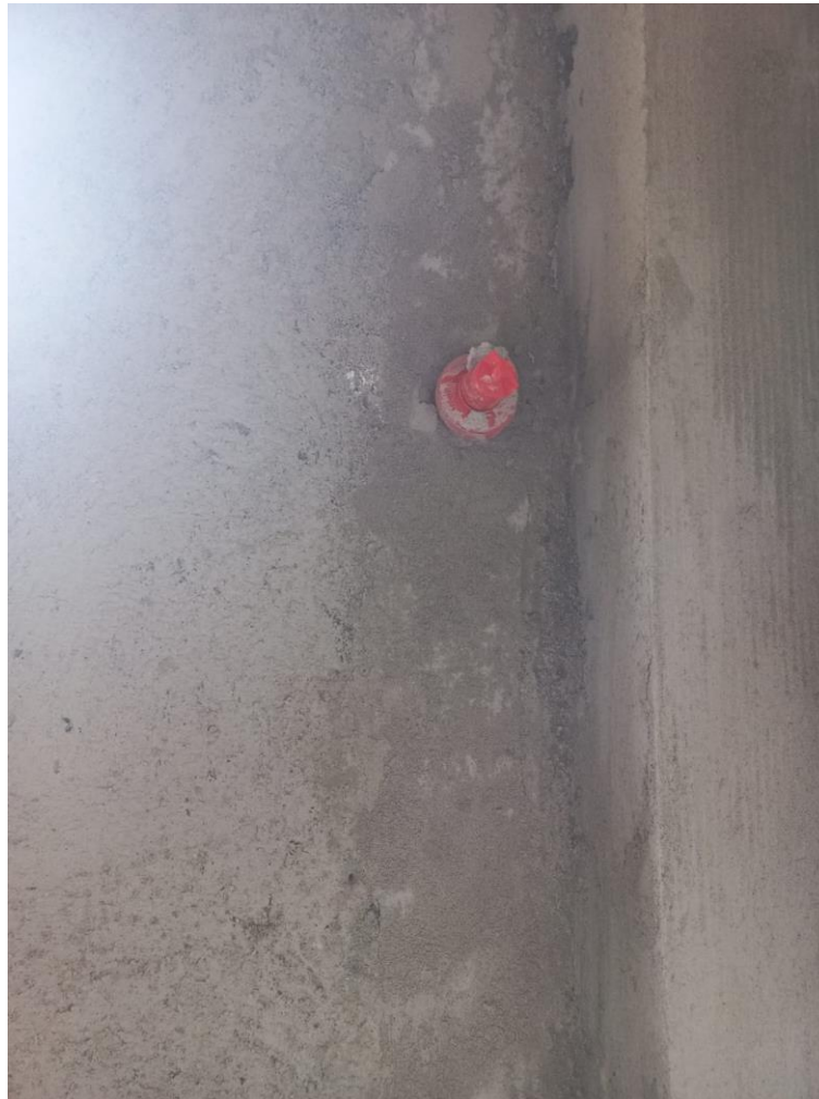
Foto 02: Registro de água
