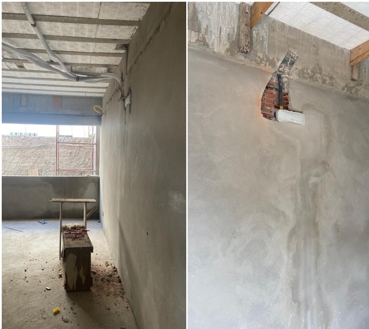
Foto 09 e 10: Infraestrutura do ar condicionado
