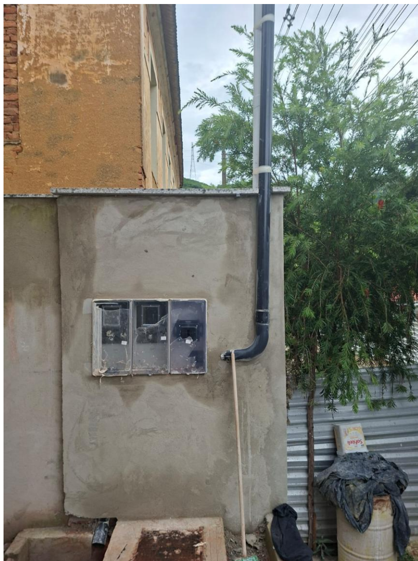
Imagem 03: Padrão de entrada de energia elétrica
