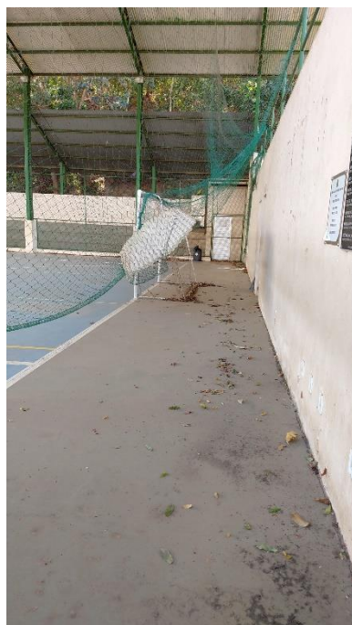
FOTO 5 – ESCOLA MARIA OLÍRIA – TELHA CAÍDA DENTRO DA QUADRA
