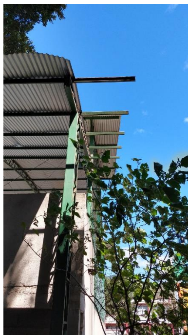
FOTO 6 – ESCOLA MARIA OLÍRIA – TELHAS SOLTAS NA ÁREA DA ARQUIBANCADA
