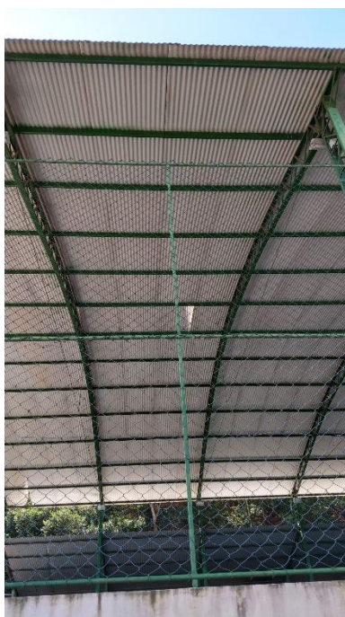
FOTO 4 – ESCOLA MARIA OLÍRIA – TELHAS SOLTAS NO MEIO DA QUADRA
