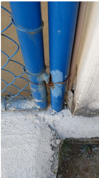
FOTO 5 – ENTRADA DA QUADRA DA ESCOLA PEDRO NOLASCO – DETALHE DO PORTÃO AMARRADO COM ARAME.
