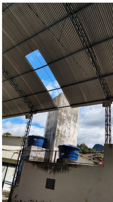
FOTO 2 – ESCOLA PEDRO NOLASCO – LADO DO PÁTIO – TELHAS SOLTAS.
