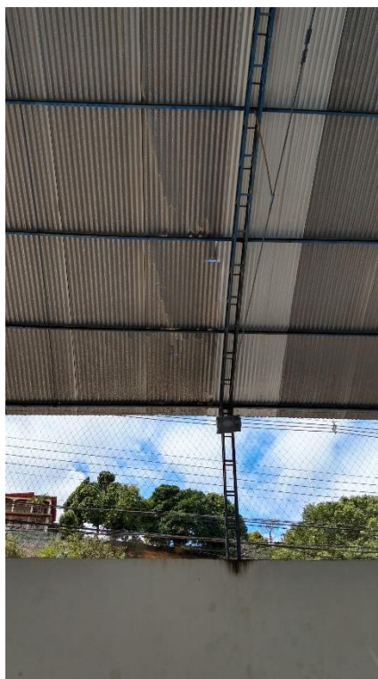
FOTO 3 – ESCOLA PEDRO NOLASCO – LADO DA RUA – TELHAS COM BURACOS.
